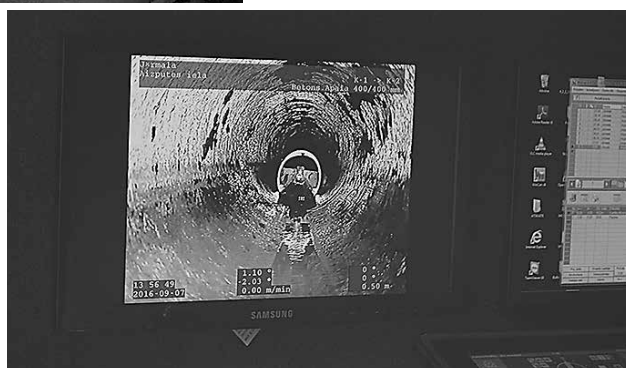
Ar CCTV video izpēti redz, kādi ir bojājumi, un kā cauruļvadi īsti zem zemes iet.
